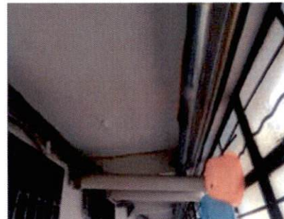
1、私拉燃气管道
