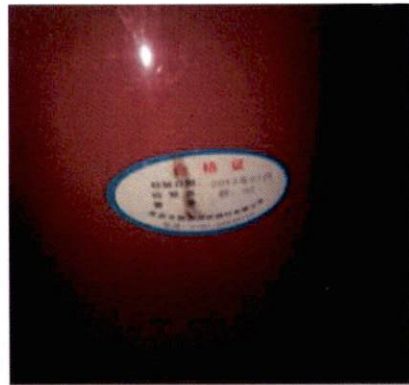
3、灭火器材失效
