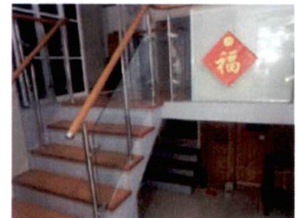
2、采用易燃材料搭建阁楼
