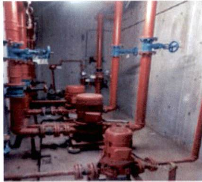
1、泵房内未配置灭火器材、应急照明
