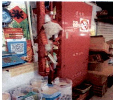
2、消防栓周围堆物
