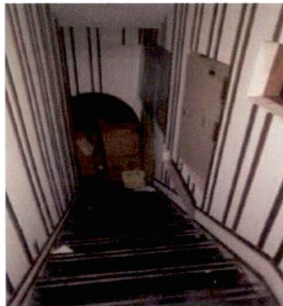
2、疏散通道堵塞
