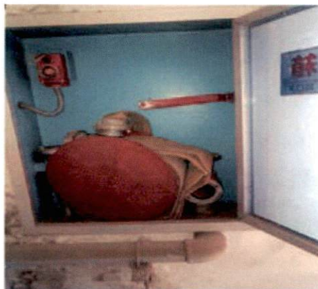
3、灭火器材损坏
